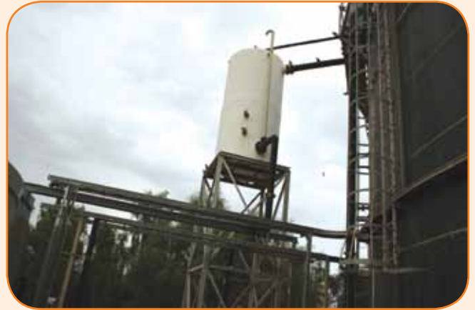
הביגז עובר למתקן ומשם למחלבה לייצור קיטור
